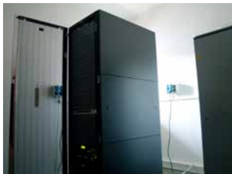
Serverovna neboli datacentrum / foto: MMZ
